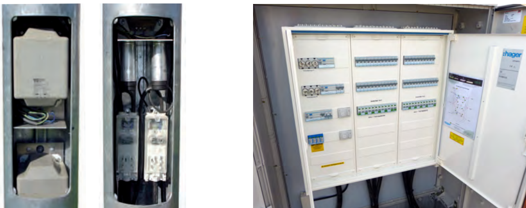
Elektroinstallationen im Flutlichtmast sowie Verteilungen
